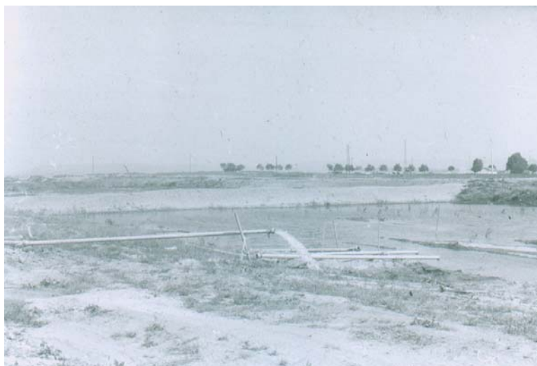
Фиг. 6.1. Уплътняване на лъос чрез водоналиване при охладителните канали на I и II блок на АЕЦ “Козлодуй”
