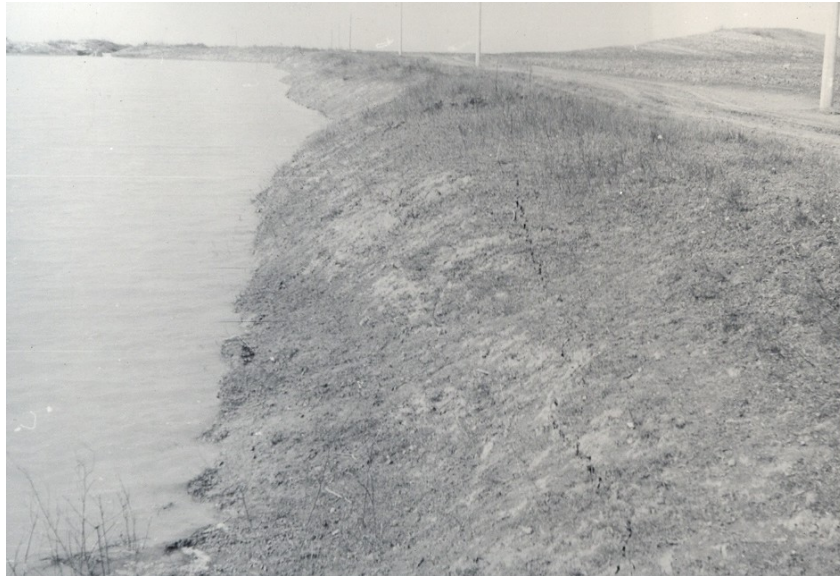
Фиг. 6.2. Уплътняване на лъос чрез водоналиване при охладителните канали на I и II блок на АЕЦ “Козлодуй”
