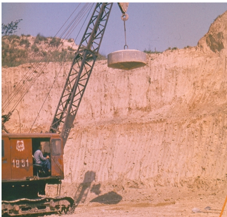
Фиг. 4.3. Уплътняване с тежка трамбовка на льосовата основа на ТВ-кулата в гр. Русе Уплътняването се прави от дъното на изкоп с дълбочина 12 m, със 7 тонна трамбовка, падаща от височина 8-10 m.
