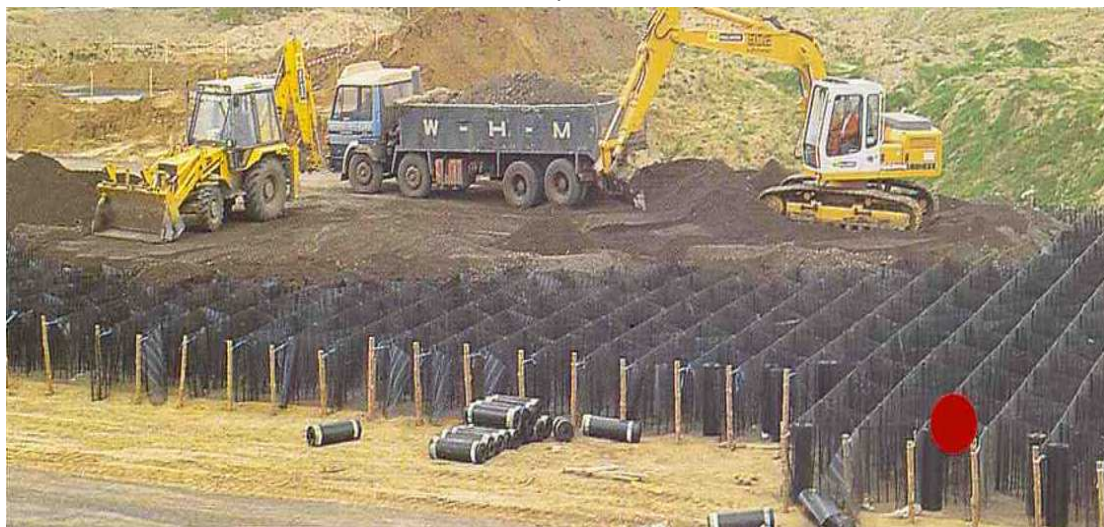
Фиг. 22.4. Изграждане на възглавница върху слаба земна основа от геоклетки, напълнени с грубозърнест материал Върху възглавницата ще бъде изграден обратен насип за промишлено съоръжение (по проспекта на фирмата Tensar)
