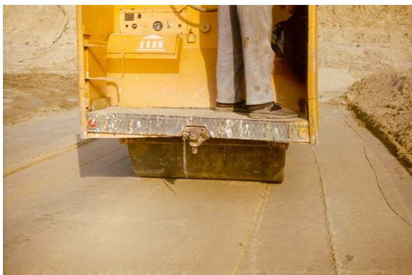
Фиг. 10.6. Изглед от близо на уплътнената циментопочвена смес. След 24 часа тя се втвърдява, не се размеква от валежите и по нея могат да се движат моторни средства, което улеснява фундаментностроителните работи и помага да се поддържа тяхното качество през дъждовните периоди от годината
