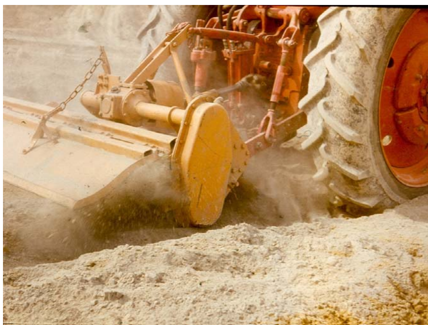
Фиг. 10.5. Смесване на лъоса с портландцимент с роторна селскостопанска фреза. Разстилането на цимента е направено със специално конструиран цименторазстилвач
