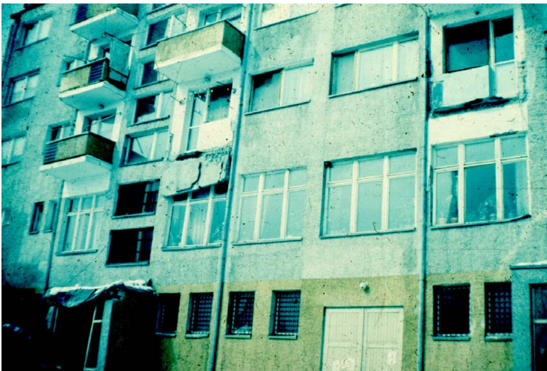
Фиг. 4.5. Разрушени балкони на сгради в гр. Стражица от земетресението с M=5.1 през м.февруари 1986 г.
