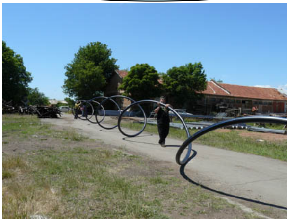
Отвеждане на изпомпаната вода от шахтата към открития резервоар
